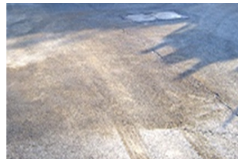
③事故収拾後の現場写真
