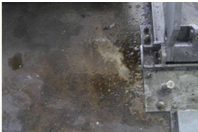
①リフト可動部の廃油塊水分を含む
